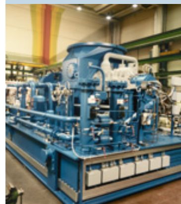
Wärtsilä, Финляндия конденсационная турбина 7 МВт
